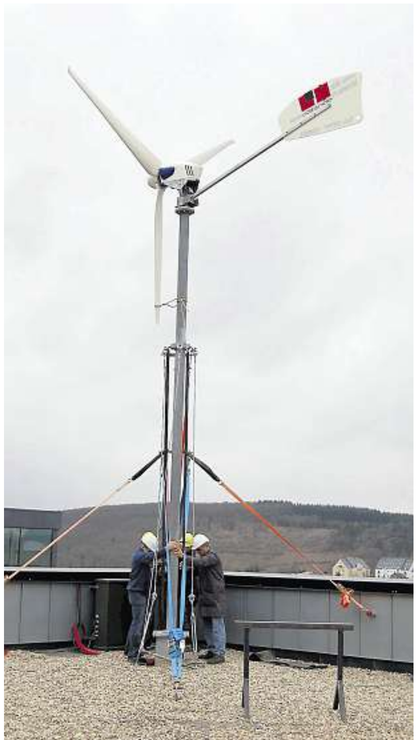
Die fertig montierte Anlage trägt das Logo des Lycée du Nord
